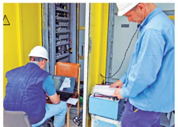
Calibrando sistema de protecciones
